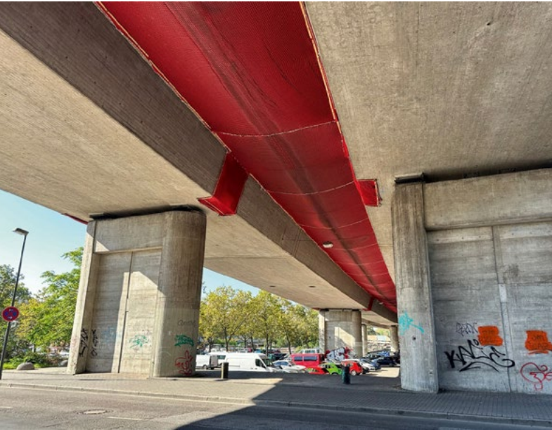
Schäden Hochstraße Nord.
